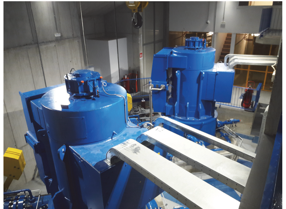
I due gruppi turbina-alternatore della nuova centrale idroelettrica di Isola realizzata dai comuni di Cevo e Saviore
