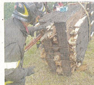
I pompieri al lavoro dopo il crollo
